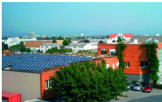
Firmeneigene Photovoltaik-Anlage der DACHLAND GmbH, Mainz
